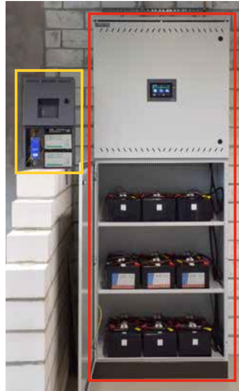
Abb. 5: Ein aktuelles CPS-System als zentrale Batterieanlage (rote Markierung) und ein LPS-System für dezentrale Anwendung (gelbe Markierung) mit jeweils verschlossenen Batterien
