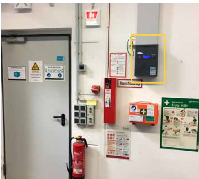
Abb. 3: Dieses LPS-System versorgt ca. zehn Leuchten der Sicherheitsbeleuchtung in einer Fertigungshalle, die als separater Sicherheitsbeleuchtungsabschnitt gilt. Das LPS-System enthält zwei verschlossene Batterien à 12 V / 7,2 Ah.
