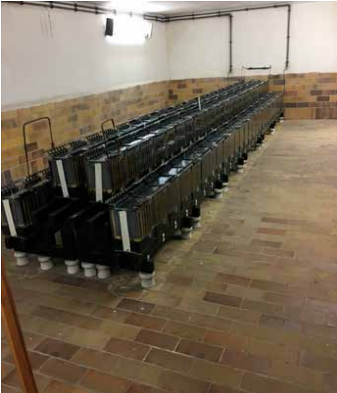
Abb. 4: Geschlossene Batterien einer Zentralbatterieanlage aus den 70er-Jahren (Darstellung ohne Ladestation)
