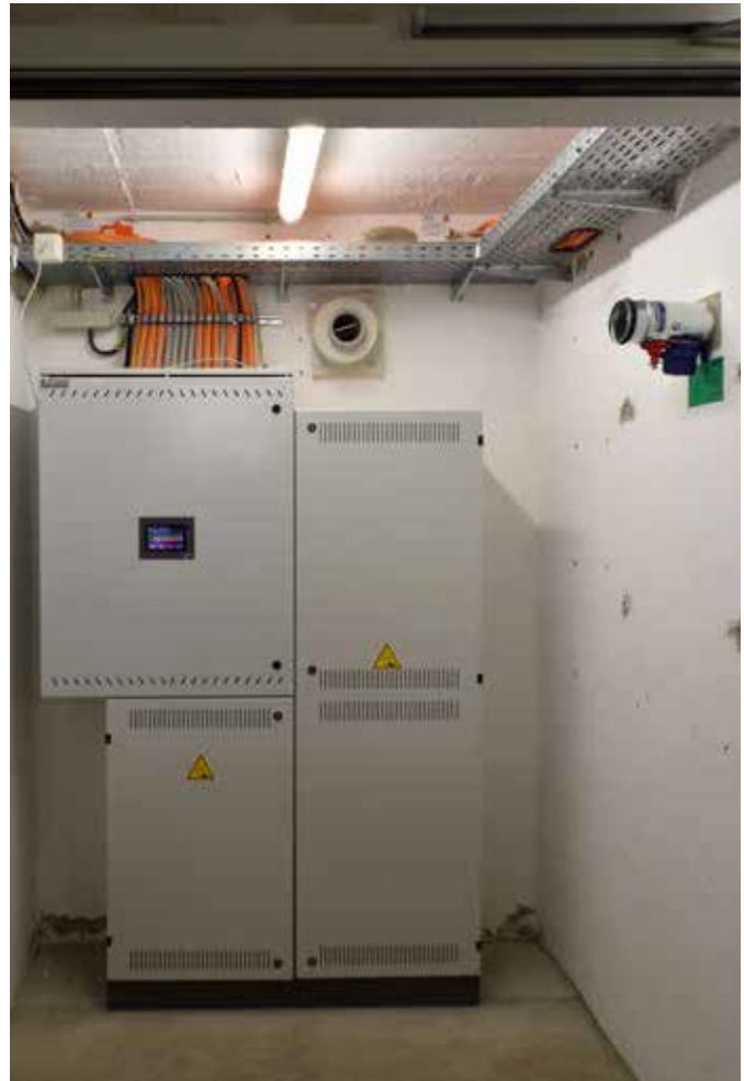
Abb. 10: Die Gehäuse der alten Energieversorgung wurden wiederverwendet und beherbergen jetzt die Batterien der neuen CPS Fusion von INOTEC (im Bild oben links).
