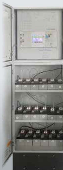
Abb. 7: Gruppenbatterieanlage mit einer Batteriespannung von 216 V (Reihenschaltung von 16 Stück verschlossener 12 V Batterien)
