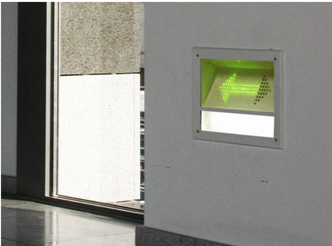
Bodennahe Leuchte mit dynamischer Fluchtrichtungsanzeige Low-location luminaire with dynamic escape route guidance
