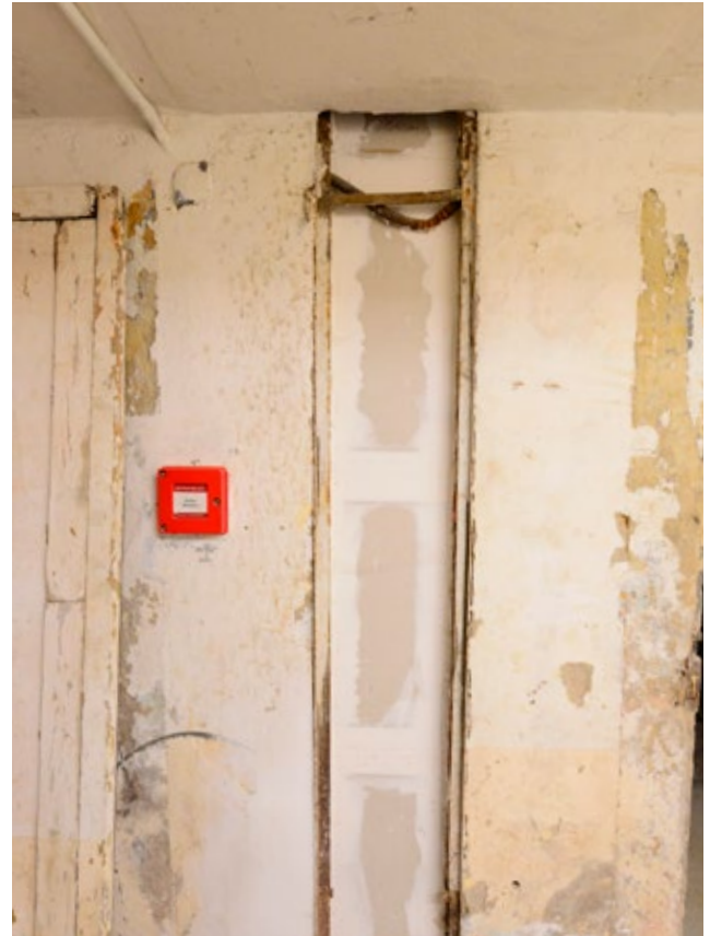
Abb. 1: Die vorhandenen Steigschächte für die Verkabelung wurden im Originalzustand belassen.
