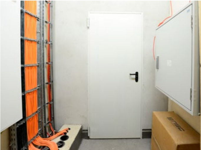
Abb. 7: Die Zellentüren wurden im Originalzustand erhalten, allerdings wurde in den zu Technikräumen umfunktionierten Zellen dahinter eine Brandschutztür installiert.
