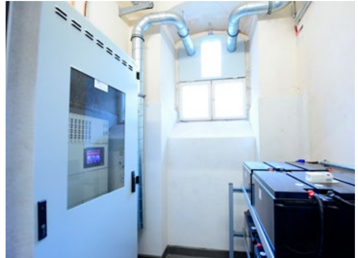
Abb. 8: Die Steuerung von Sicherheitsbeleuchtung und optischer dynamischer Fluchtweglenkung befindet sich in einem Kellerraum, wo auch die Notstromversorgung als Zentralbatteriesystem (CPS 220/64 mit CP D.E.R. Einschüben) untergebracht ist.
